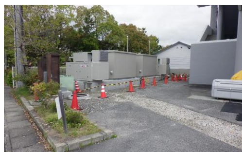
④消防・防災施設整備事業（湖南広域行政組合）
